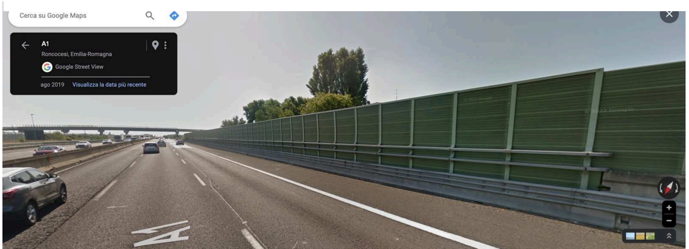
Figura 2 - Stato barriere antirumore agosto 2019
